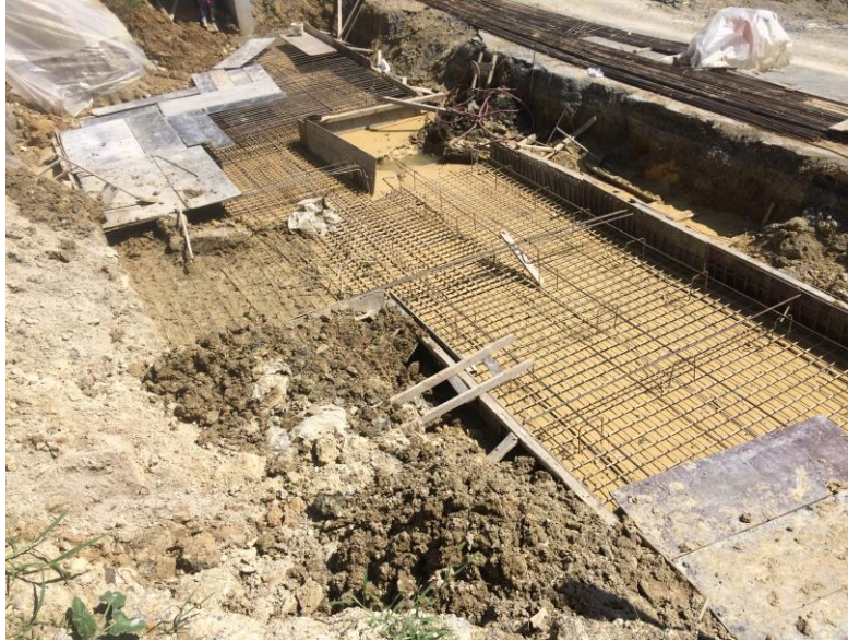
Şekil 1 Sağnak yağış sonrası temelin çökmesi
