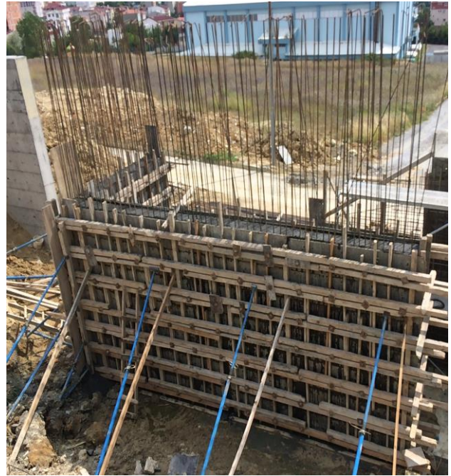
Şekil 2 Beton dökülen perde duvar
