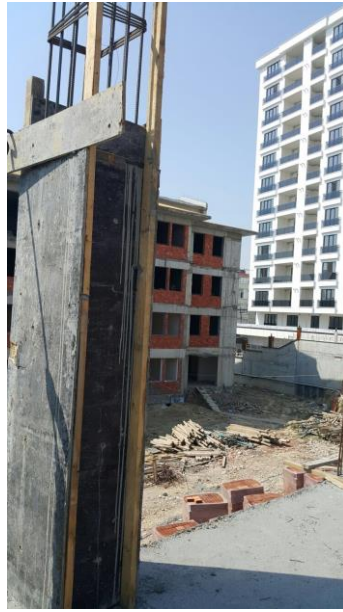
Şekil 1 Betonu dökülen kolon donatısının priz alması
